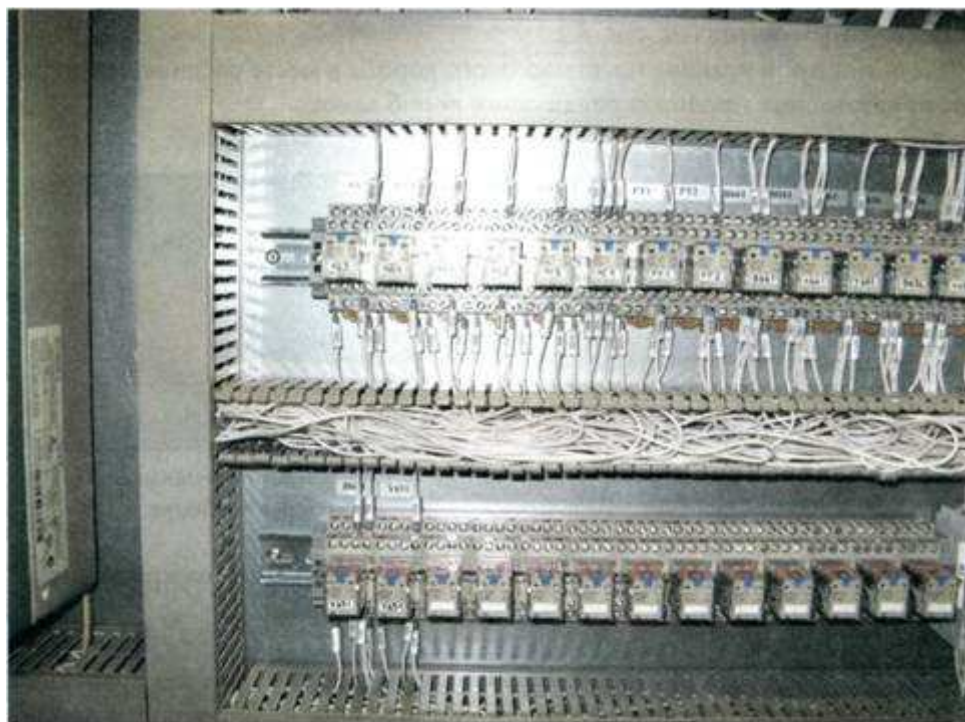
Рисунок 7.36 – Общий вид электроконструкции управления с использованием каналов для прокладки проводов
